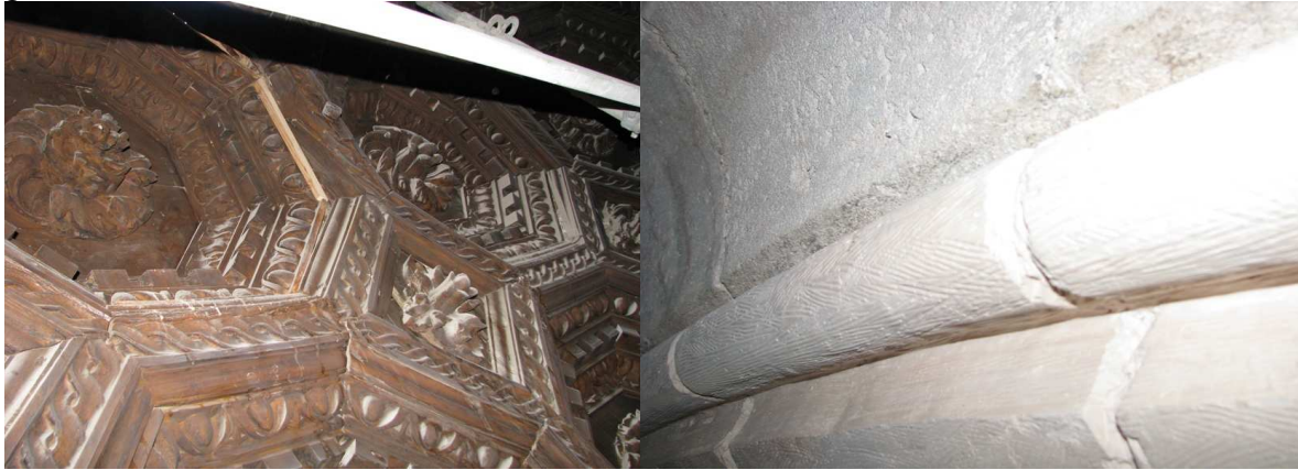
Fragment drewnianego stropu w stylu Mudejar oraz uzupełnienia kamienia, widoczna faktura opracowana gradzią.
